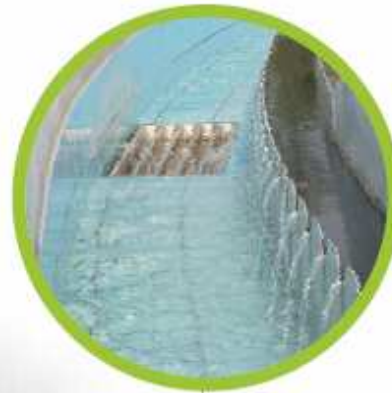
Traitement de l'eau potable
