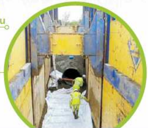
Collecte des eaux usées et pluviales
