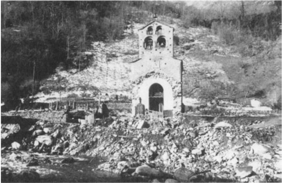
La destruction de l'Église de Salau lors de la crue du 7 novembre 1982 - Source : Francis Sans
